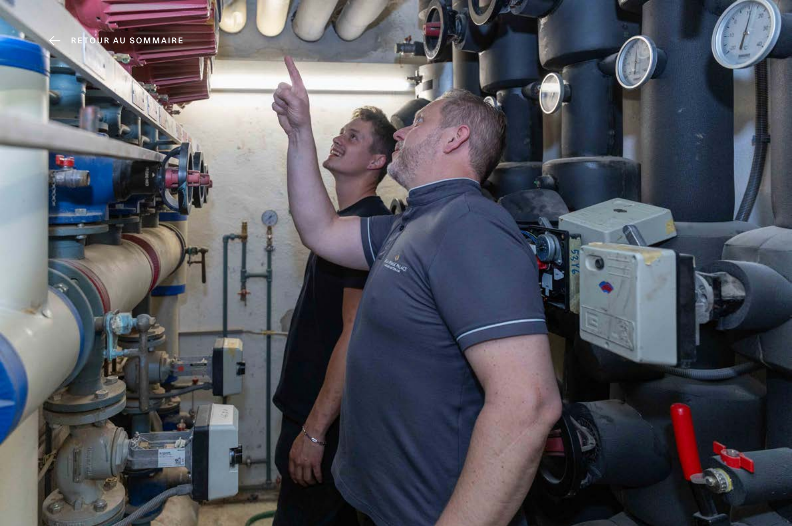
Julien Bompais (Technique, BRP SA) fait le relevé de nos compteurs d'énergie avec notre partenaire au Beau-Rivage Palace.
